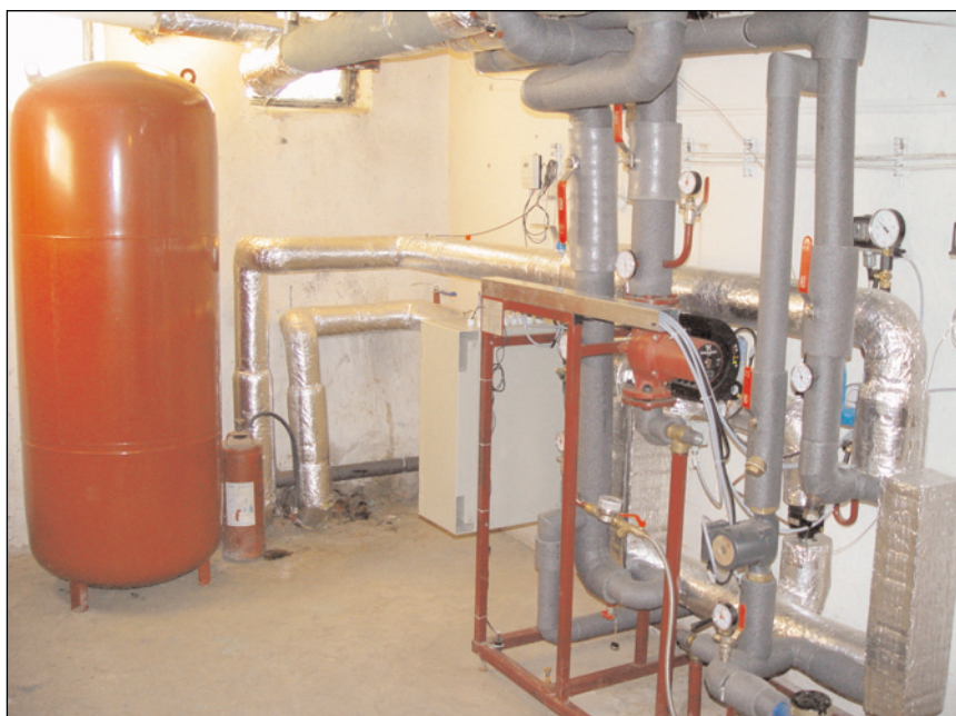
Domová odovzdávacia stanica v bloku O-5, náhrada stratového výmenníka "O"
